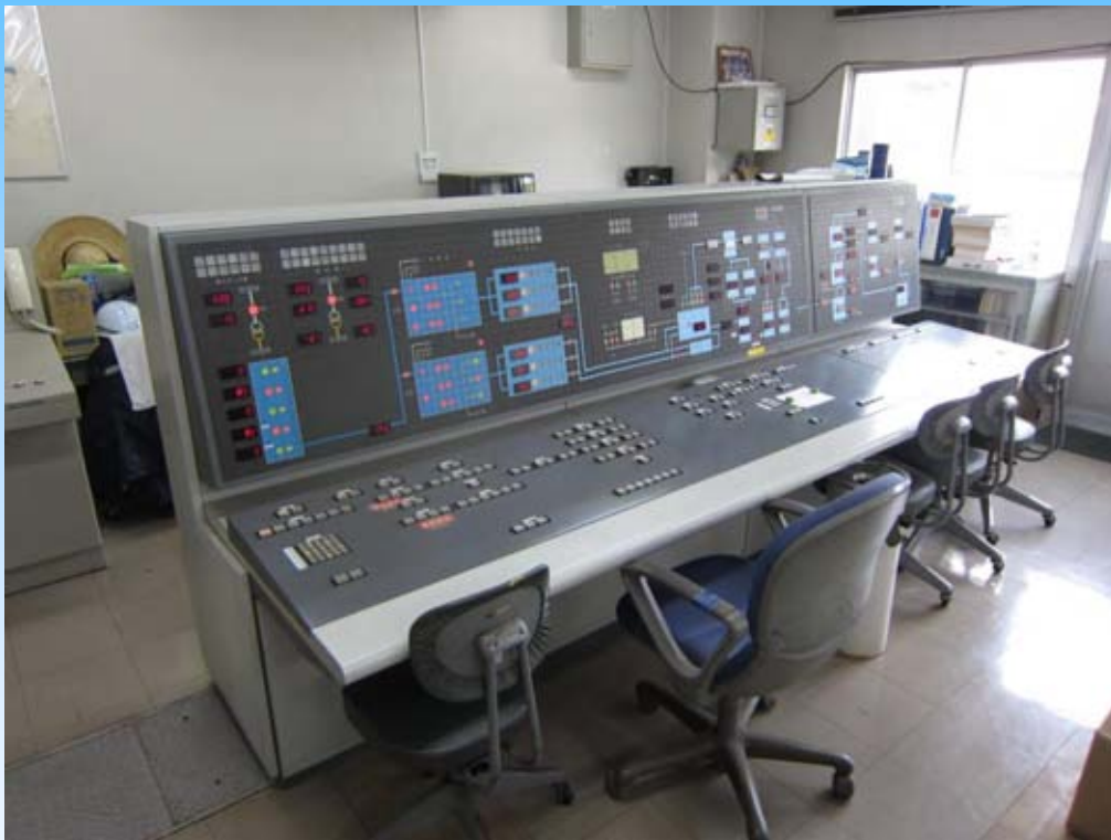
＜従来形＞ ミニグラフィックパネル操作卓監視設備
