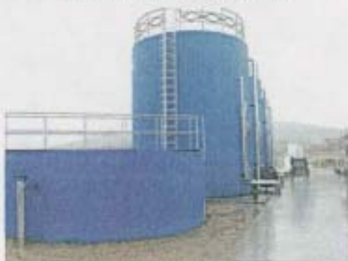
渗滤液处理厂
