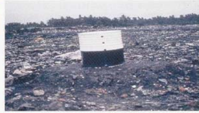
廃ドラム缶を使ったガス抜き設備
